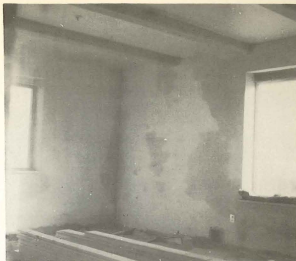
Fig.14. Fugtskjolder i nybygning med 31 cm hul ydervæg med isolerende, opblæret teglgrus i hulrummet. Fugtskjolderne fremkom efter meget kraftig slagregn, og pudslaget blev desværre hugget af og vægfladen asfalteret og atter pudset, således at årsagen til fugtskjolderne ikke kunne fastslås.
