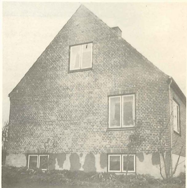
Fig.8. Fugtskadet gavl uden udhæng. Ved åbning af et antal stødfuger over soklen strømmede vand ud. Efter reparation af mørtlen langs tagste- nene og tætning af åbne fuger mel- lem vindueskarme og false ophørte generne.
